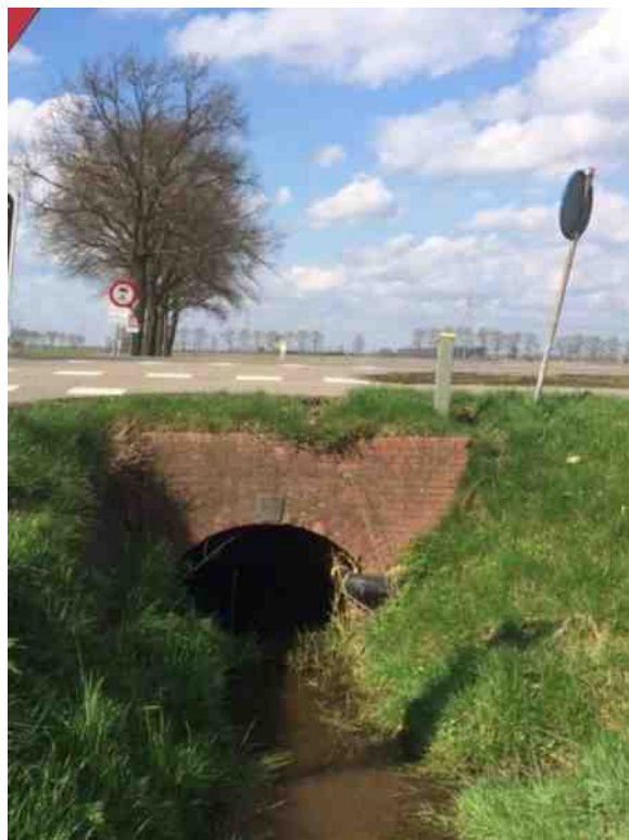
Oplossing vorige Raad de Plaat. Duiker bij de Afweg.
